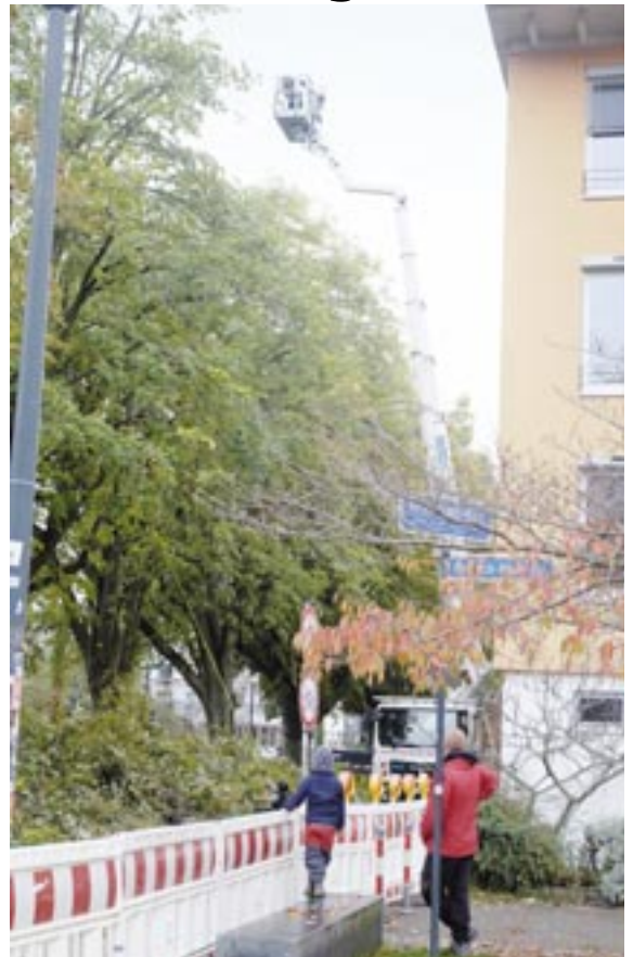
Bei den übrigen Bäumen wurden von der Hubbühne aus pilzbefallene Zweige und Äste weggeschnitten. Fotos: R. Schepers
